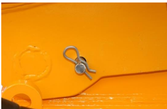
Låsebolt montert og låst med splint i begge ender.
