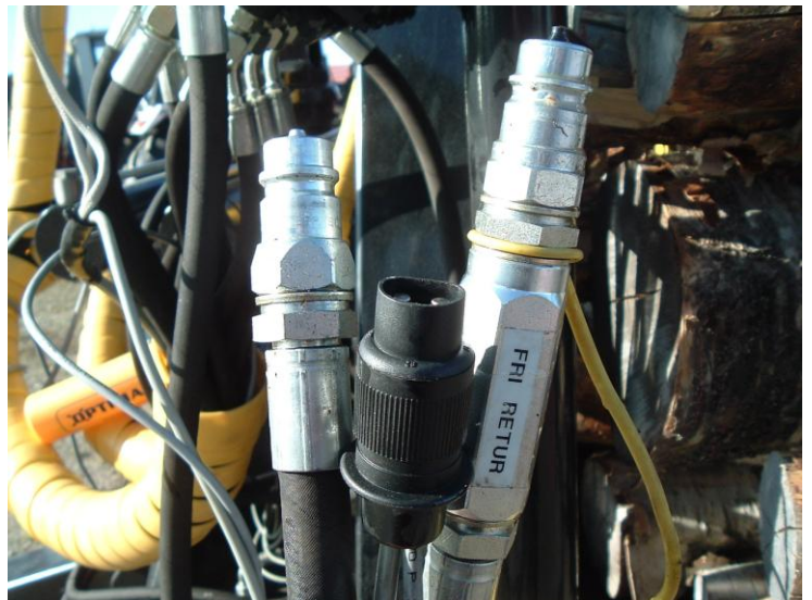
Hydraul- och elanslutningar till kran och stödben (på vagn med lättviktspaket).
